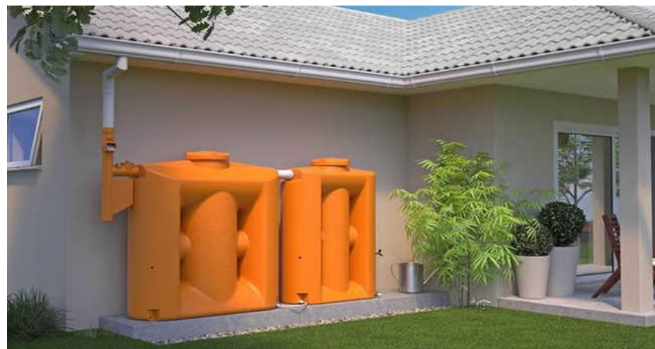
Figura 83: Captação de Água da Chuva - Cisternas Vertical
