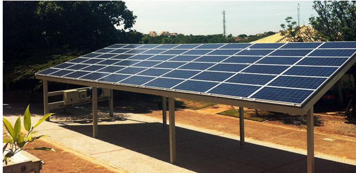
Figura 38: Placa Solar instalada no terreno
