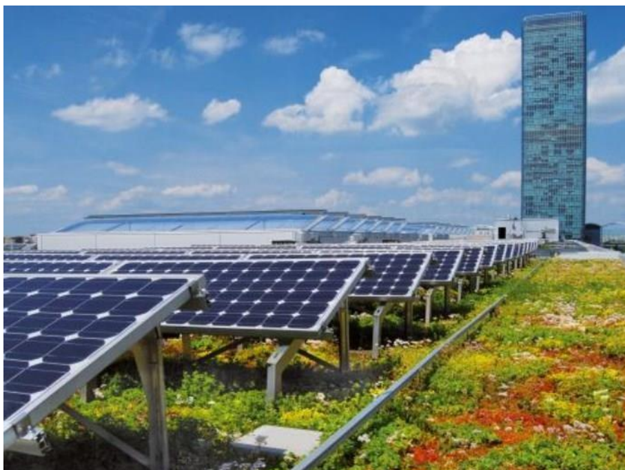
Figura 90: Placas fotovoltaicas instaladas em telhado verde
