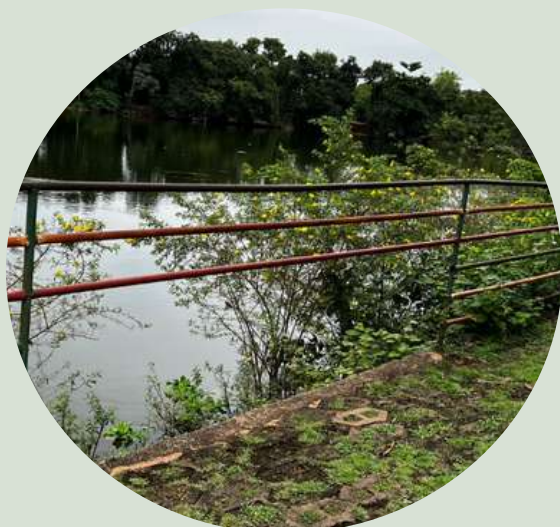
Figura 16: Guarda - corpo danificado
