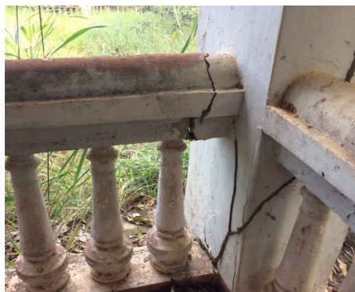
Figura 34: Trinca na cerca de balaústre
