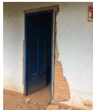
Figura 35: Perda de reboco
