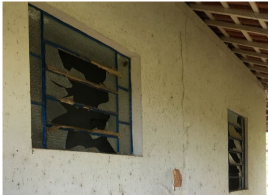
Figura 30: Perda de vidraça
