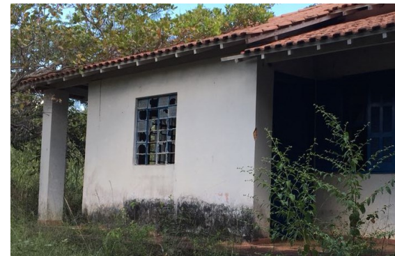
Figura 32: Perda de reboco
