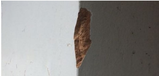
Figura 29: Perda de Alvenaria
