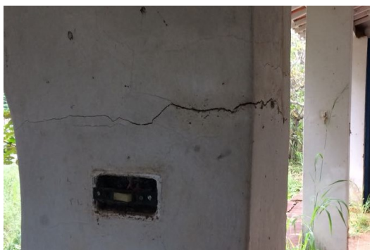
Figura 33: Trinca na estrutura
