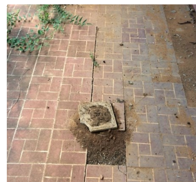
Figura 36: Descolamento do piso cerâmico
