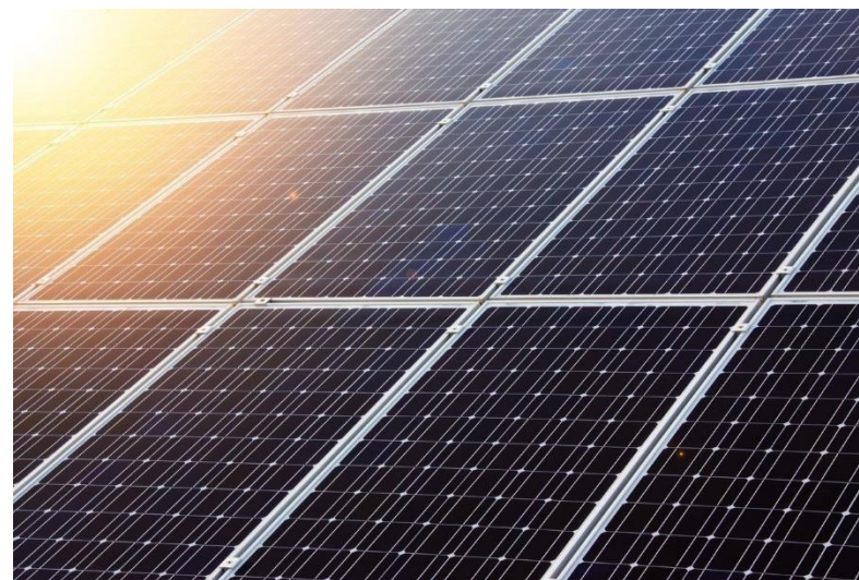
Imagem 49 – Placa Solar. Fonte: https://www.mundodaeletrica.com.br/placas-solares
