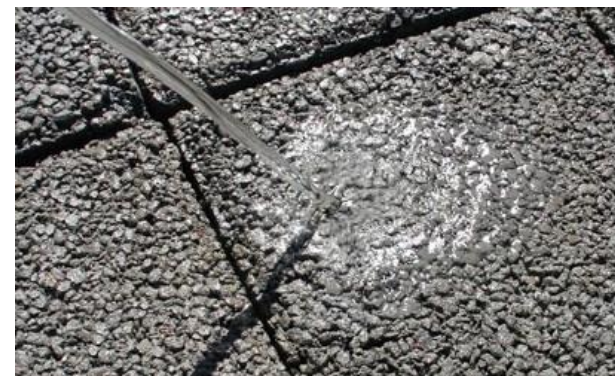
Figura 28: Piso drenante de concreto e fibras naturais
