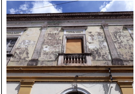
Figura 40 - Descascamento pintura fachada
