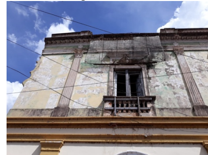
Figura 39 - Trecho desmoronado na platibanda
