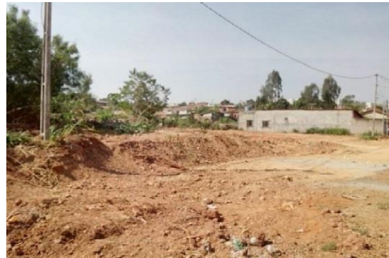
Figura 93 - Ponto 15 erosões no solo exposto, movimentação de terras
