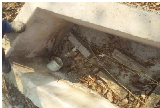
Figura 101 - Redutor de velocidade no ponto de lançamento do esgoto tratado no afluente adjacente a ETE
