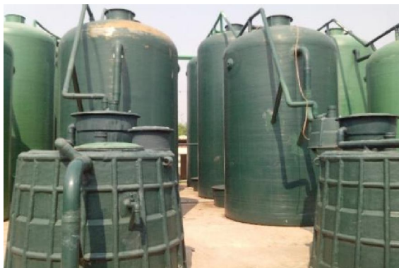
Figura 100 - Tanques UASB da ETE no ponto 16
