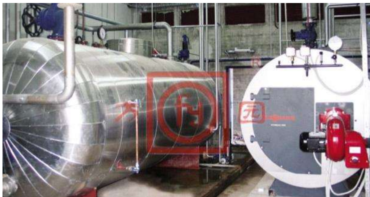
Figura 9 – Acumulador de vapor e caldeira
