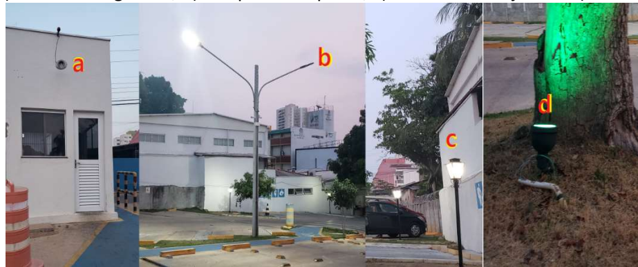
Figura 30: a) Fachada da guarita; b) Lâmpadas no poste; c) Luminárias de jardim d) Luminária espeto.
